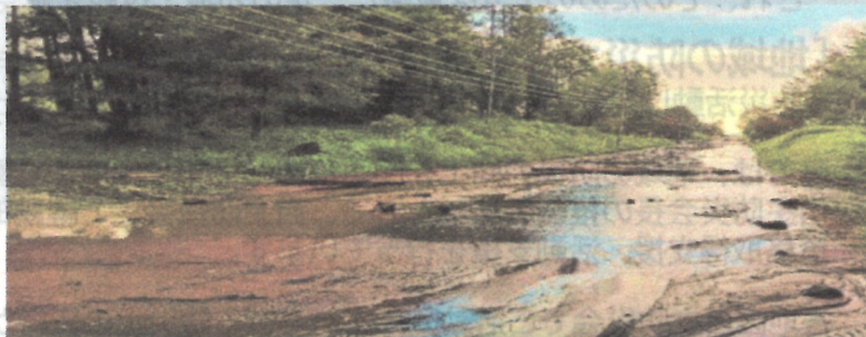
H30年 台風24号に伴う災害で、鉢巻道路に土砂が流入した様子
